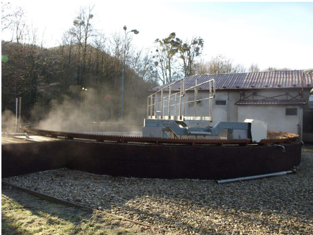
Obr. 21 Dosazovací nádrž pro větší čistírny celkový pohled
