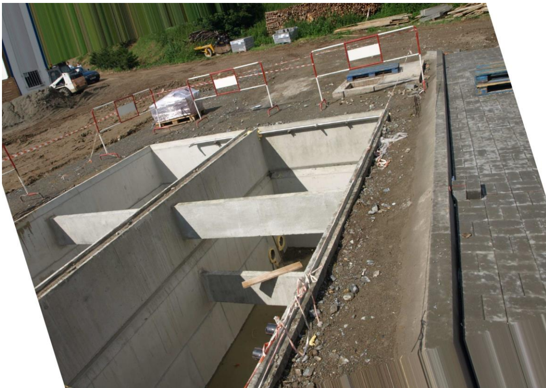
Obr 12 Prefabrikovaná ČOV Nihov
