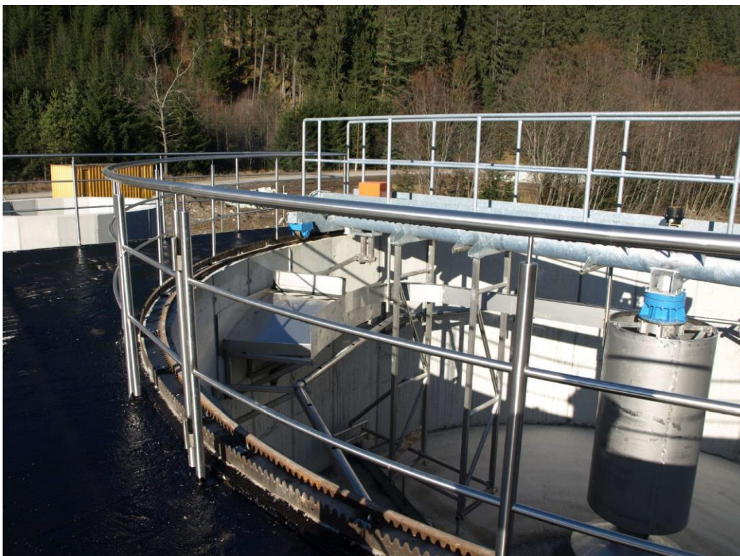
Obr. 19 ČOV Oravice dosazovací nádrž
